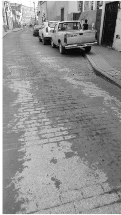
Nota: Vehículos invadiendo y reduciendo el área útil de banqueta.
