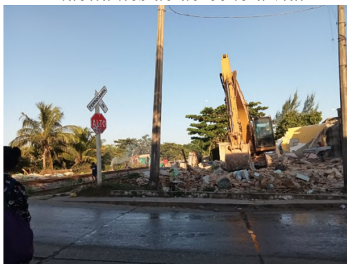
Figura 3. Destrucción de las viviendas de los habitantes de derecho a vía.
